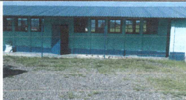
Foto 2: VENTANAS DE AULAS #3, #4, LIBRERIA Y DIRECCION.
