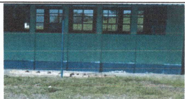
Foto 3: VENTANAS DE AULAS SIN BALCONES #3, #4 LIBRERIA Y DIRECCION.
